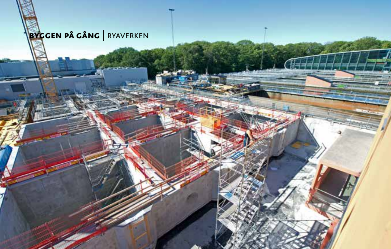
Gjutning på gång. Längst bort i bild är det snart dags att gjuta in armeringsjärnet i betongväggar.
